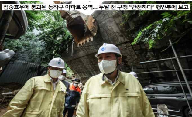
<사당동 동작구 아파트 옹벽 급경사지>
